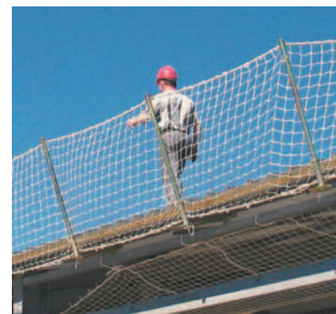
Filets périphériques et filets en sous face.
